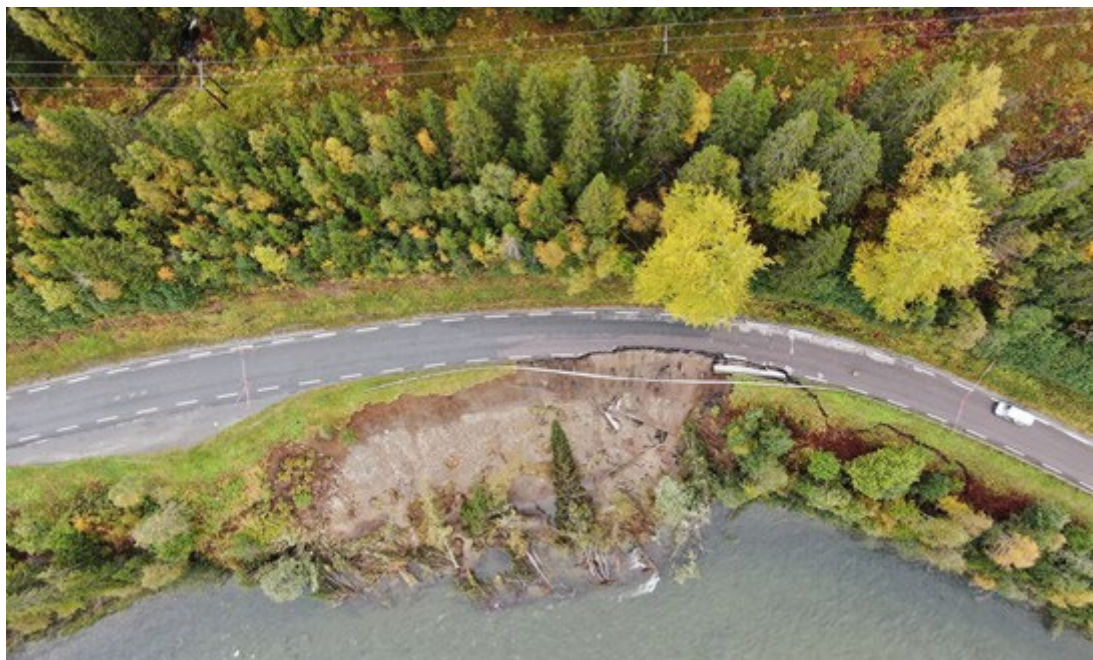
Jordras med påfølgende veibrudd i Nevernes i Nordland Foto: Nordland Fylkeskommune
